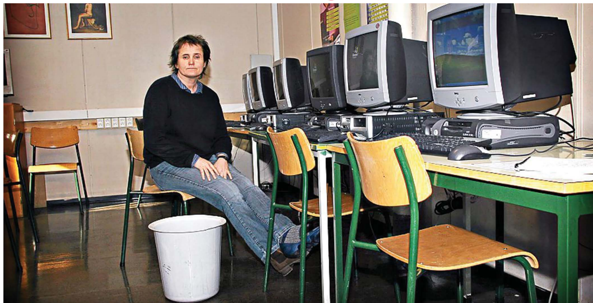
Rektor Guro Kirkerud ved Biri ungdomsskole må ta bøtter i bruk for å samle opp vann fra vannlekkasjene i datarommet. FOTO: JOACHIM SEEHUSEN / TEKNISK UKEBLAD
